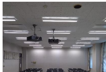
立教大学 新座キャンパス 2号館 照明器具更新
