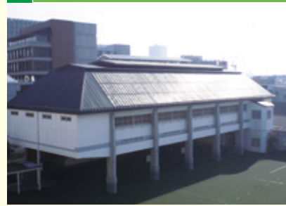
立教小学校 太陽光パネル(55.5KW)(2003年)
